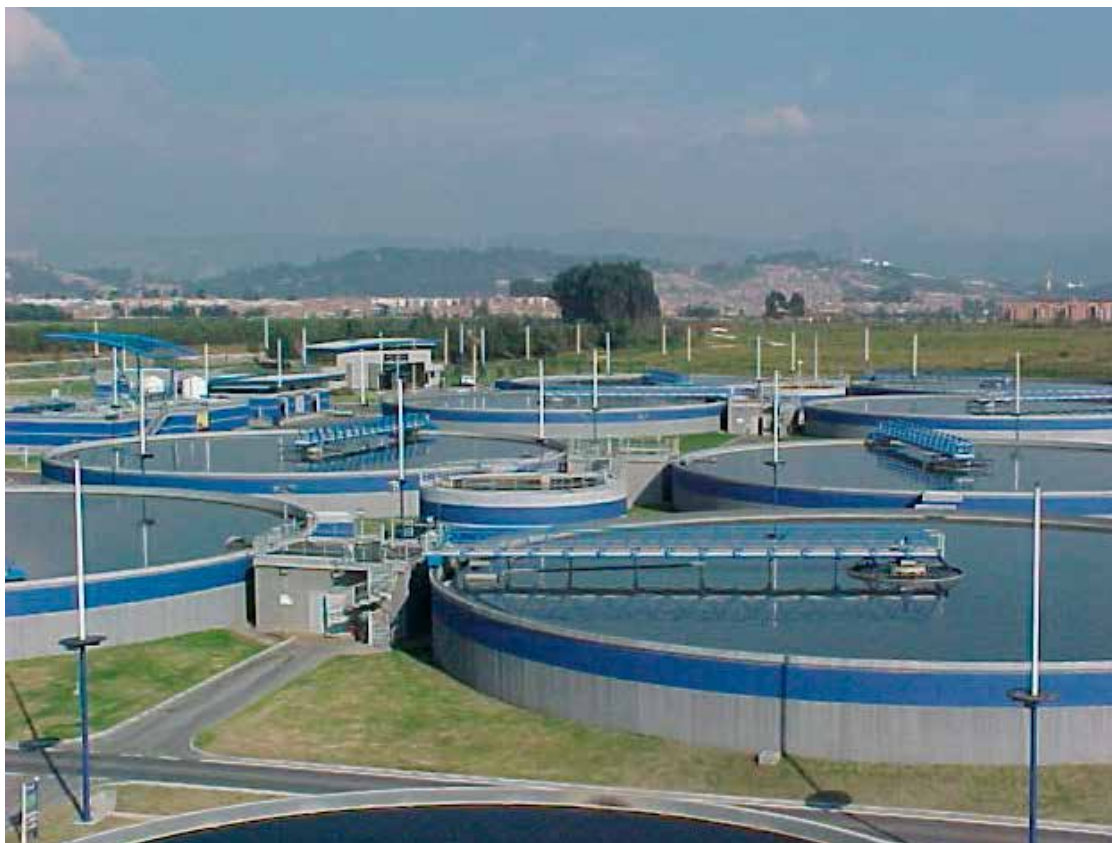
Sistema de tratamiento de aguas.
