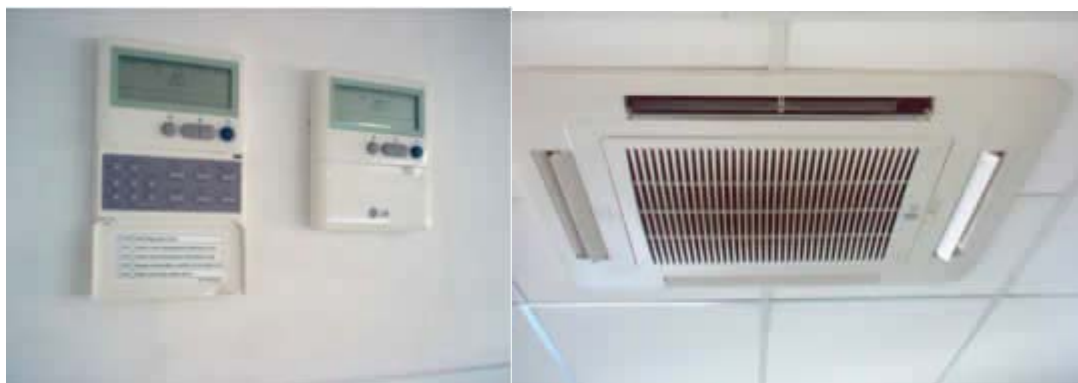
Fotografía 6. Sistema de aire acondicionado
