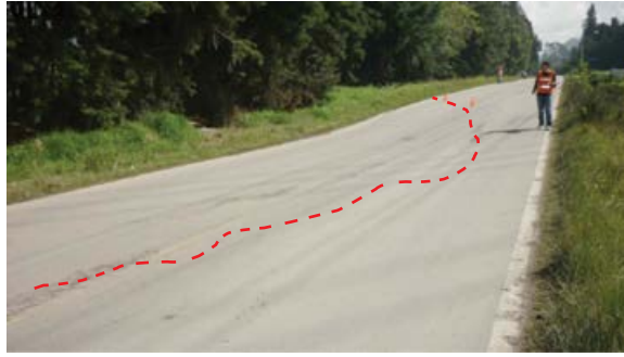
Figura 1. Deterioros en superficie asociados a la acción de barreras vivas, vía Siberia-Tenjo
