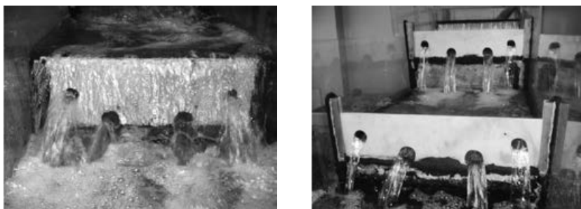
Figura 5. Pantallas de control en escalón
