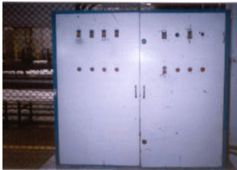
Figura 20. Centro de control de motores bombas.
