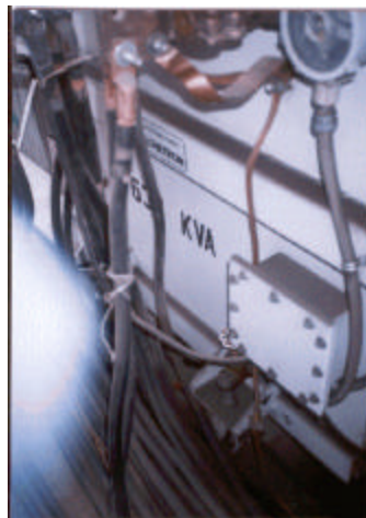
Figura 22. Puente entre los bornes de neutro y tierra en los transformadores.
