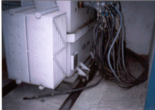
Figura 18. Conductor sin conectar en la fase Z del transformador 2.
