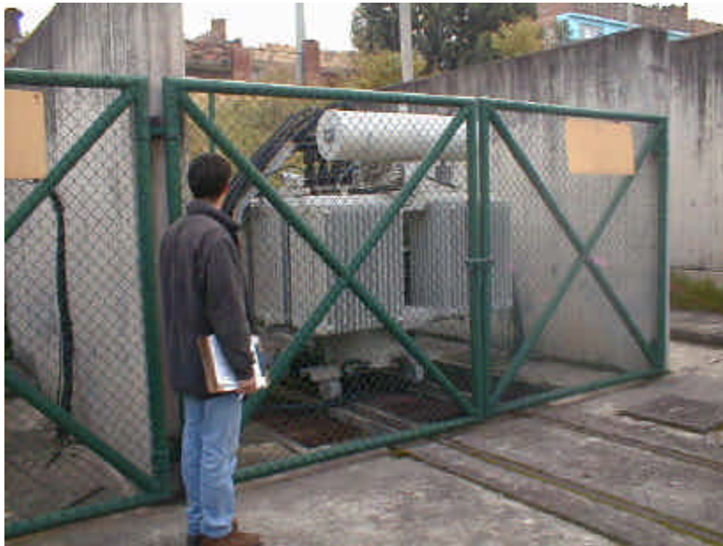
Figura 3. Transformador # 2, Estación Columnas
