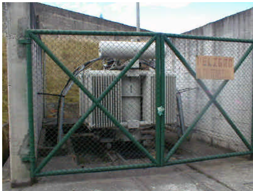
Figura 5. Transformador de patio, Estación San Vicente
