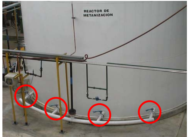
Foto 4 Alimentación al reactor de metanización
