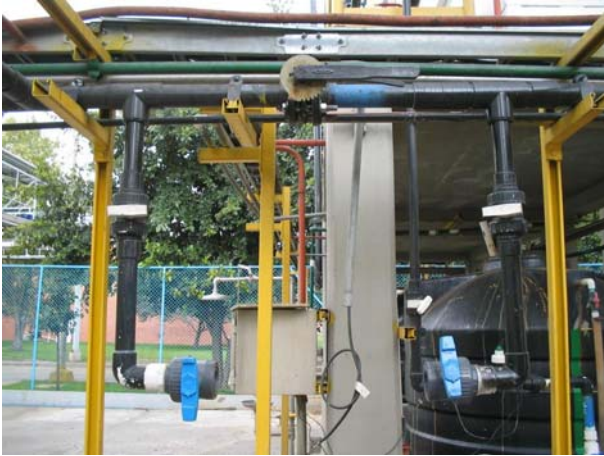
Foto 1 Anterior ubicación del medidor de flujo electromagnético
