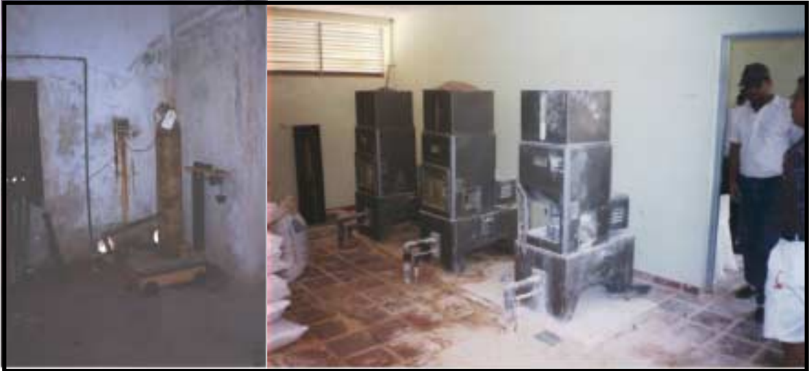
Foto 6. Problemas en la Planta de tratamiento. (a) Cloración (b) Dosificación de floculante.
