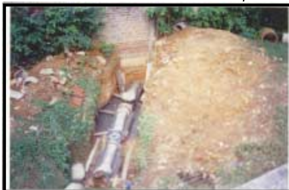
Foto 1. Instalación de macro medidores a la salida del tanque de almacenamiento
