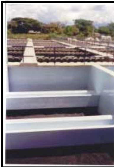
Foto 7. Optimización de unidades de filtración
