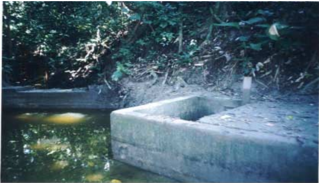
Foto 8. Nacedero de agua del cual se bombea agua para suministrar el tanque elevado del cual se tomaron muestras para análisis, y en el cual se encuentra un desarenador.
