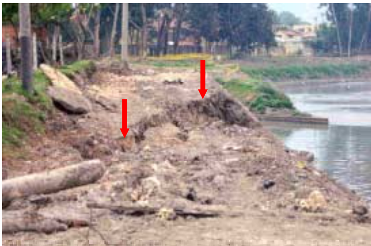
Foto 19 Inestabilidad del terreno
