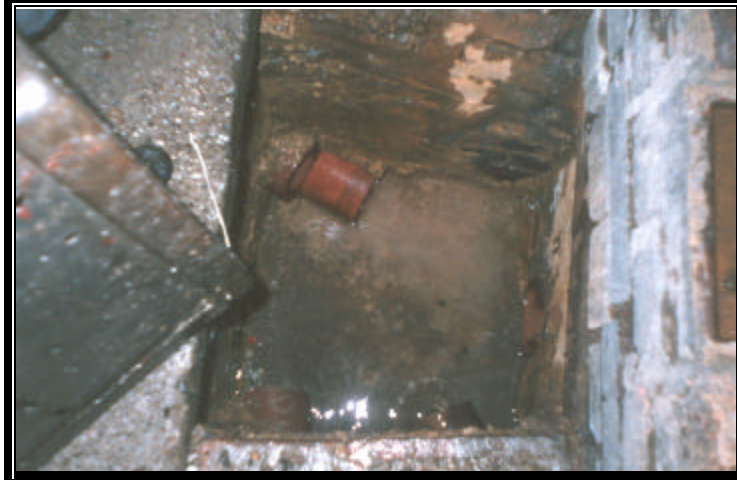
Foto 9. Caja de Inspección
