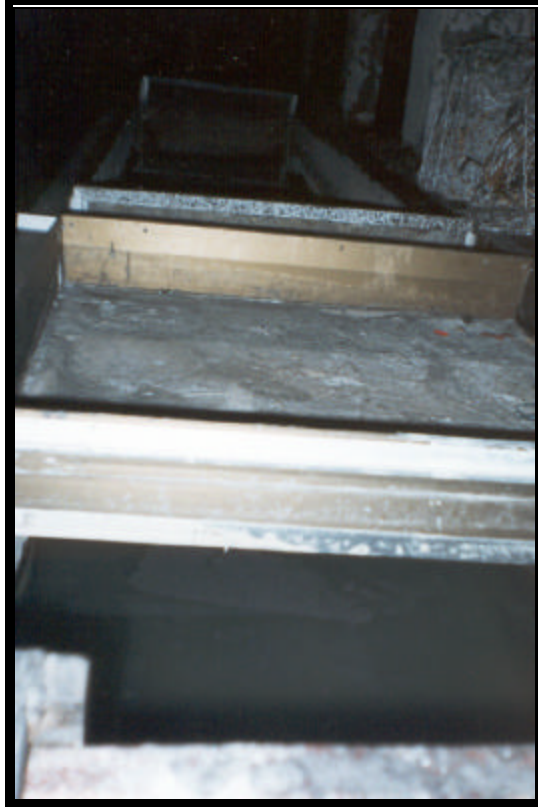
Foto 11. Tanque de Tratamiento
