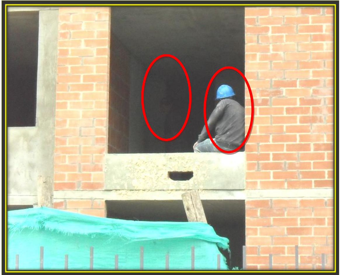
Foto 07: Empleados sin conciencia de peligros.
