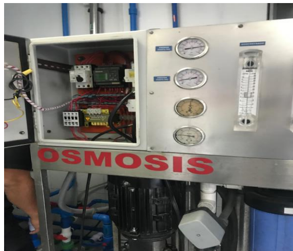
Ilustración 9. Planta de osmosis inversa. Fuente: autores
