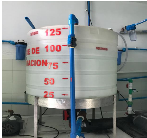
Ilustración 11. Tanque estacionario de flujo. Fuente: Autores
