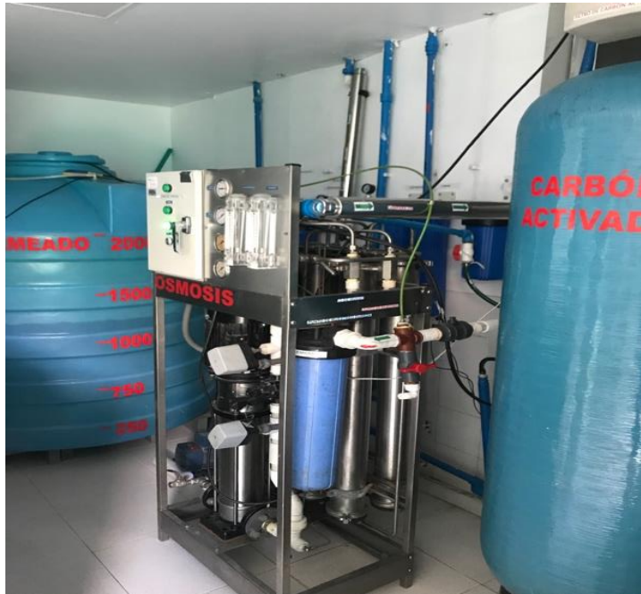
Ilustración 5. Planta de osmosis inversa hospital tunal. Autores
