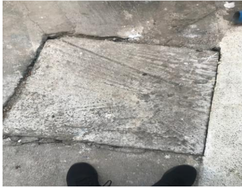
Ilustración 8. caja de inspección de aguas residuales. Fuente: autores
