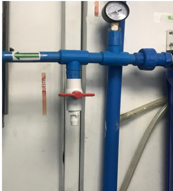
Ilustración 15. Punto de muestreo del agua salida de osmosis inversa. Fuente: Autores
