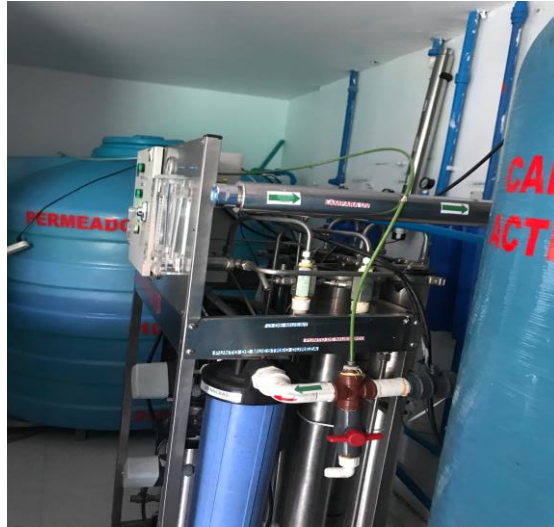
Ilustración 10. Tanque de permeado. Fuente: Autores
