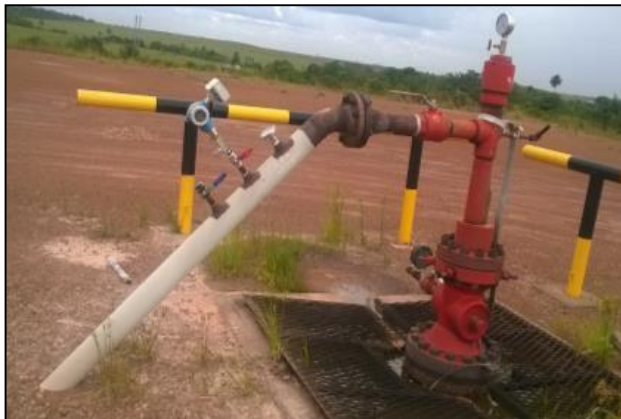
Ilustración 11: Pozo de Crudo. Instrumentación Bombas electro sumergibles
