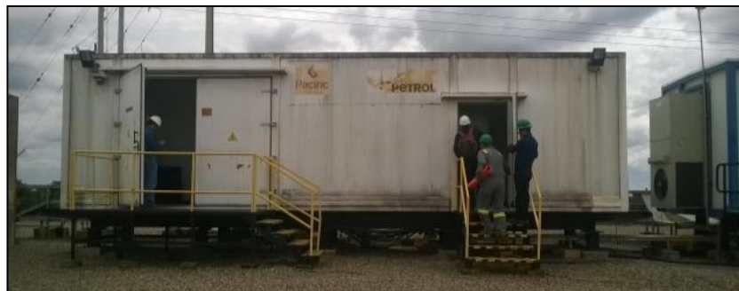
Ilustración 9: Shelter de Sincronismo de Red-Generadores
