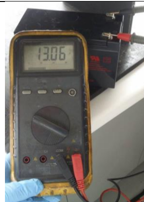
Voltaje de la batería, después de ser cargada con el panel solar.
