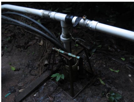
Figura 13: Punto de bombeo, Toma de agua para riego; Fuente: Autores
