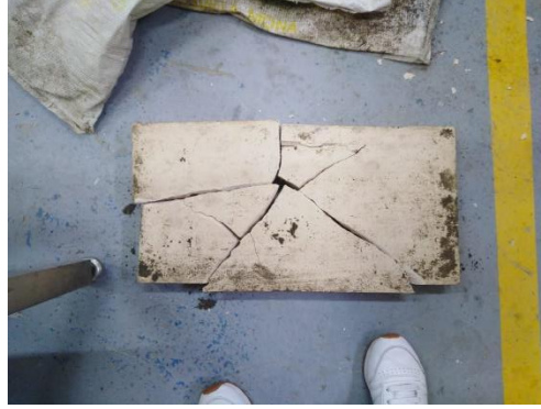
Figura 25. Evidencia de falla de la placa.
