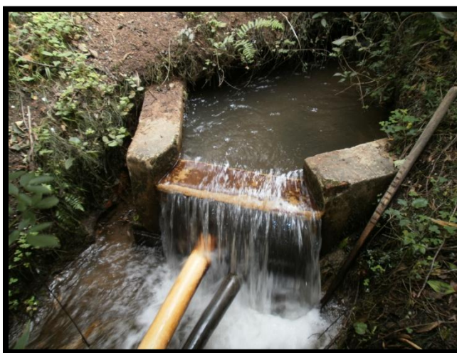
Figura 4. Punto 1. Bocatoma del acueducto.
