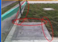
FALTA PERFILAR LA GRAMA CONTRA EL BORDILLO Y LA CAJA EN ZONAS VERDES AL OCCIDENTE DE LA OBRA HACIA EL ANDEN.
