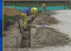
EN ACTIVIDAD DE EXCAVACION PARA VIGA EN ZONA NORORIENTAL DE LA OBRA AL LIMITE DE LA MISMA.
