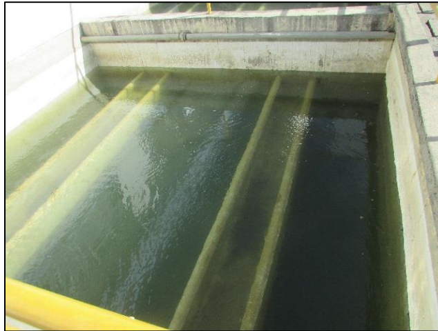
Imagen 7. Unidades de filtración de la PTAP Fuentes: Autores.
