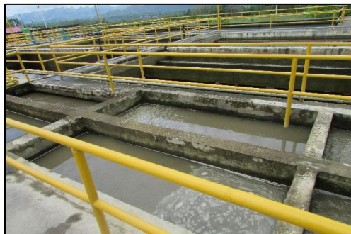
Imagen 5. Unidades de floculación de la planta de potabilización. Fuente: Autores.
