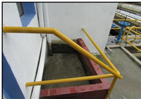
Imagen 3. Cámara de llegada del Distrito de Coello a la PTAP.
