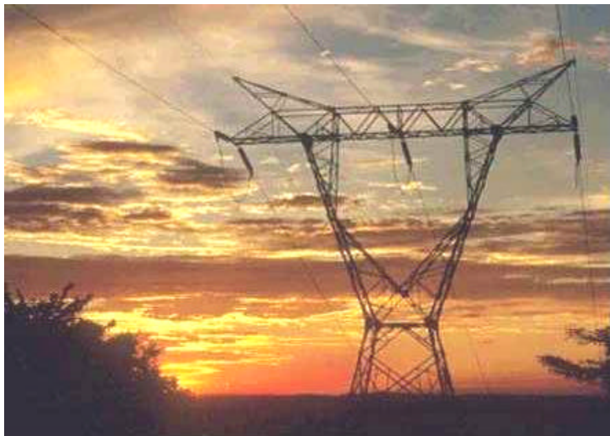
Figura 4. Línea de transmisión
