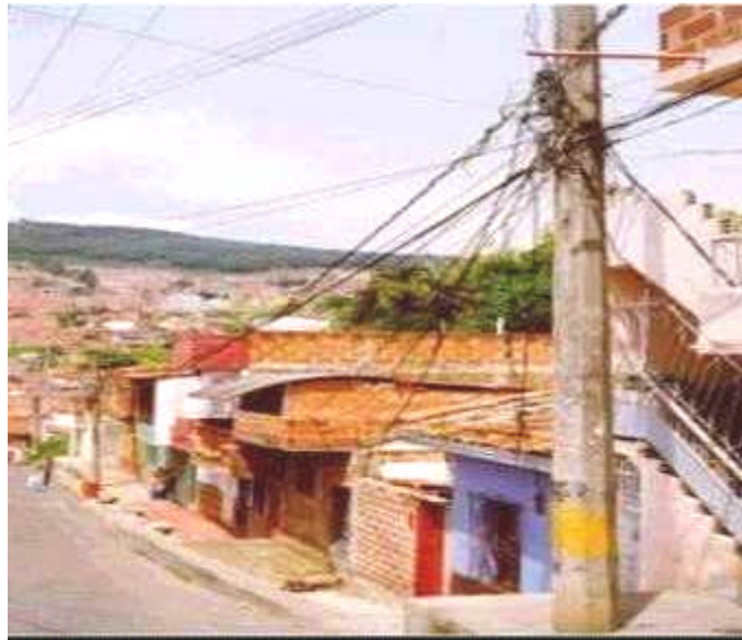
Figura 30. Redes sin remodelar
