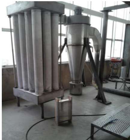
Figura 24. Ciclón y filtro de manga en industria de ornamentación metálica
