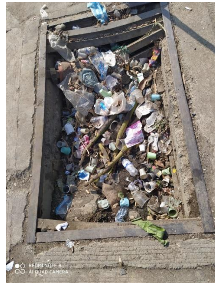
Figura 8. Acumulación de residuos en cunetas y zanjas
