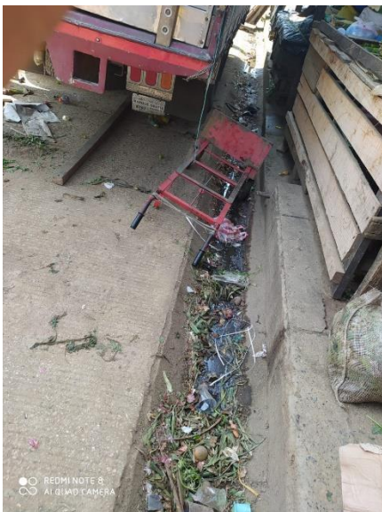
Figura 7. Acumulación de residuos en cunetas y zanjas
