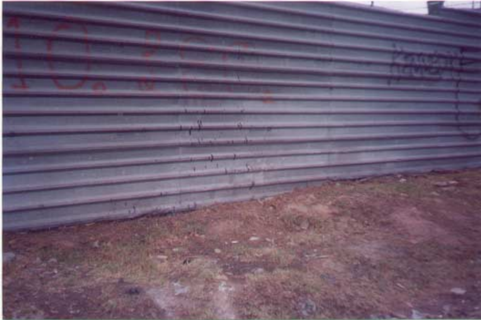
Figura 3. Cerramiento en lámina galvanizada.
