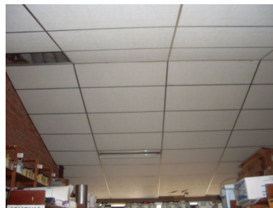
Foto 3 Interior de la bodega Falta de ventilación
