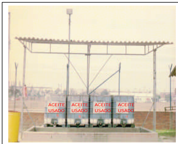
Foto 36. Área de almacenamiento temporal.
