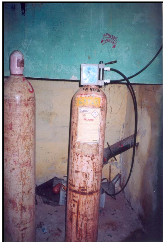
Sala De Cloración
