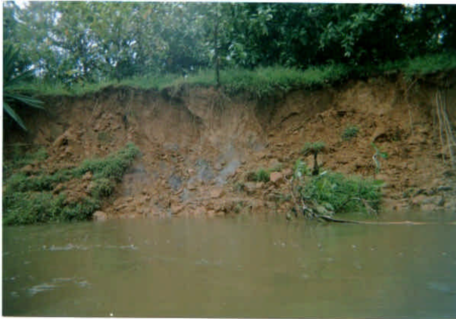
FOTO #4, Erosión de los taludes.
