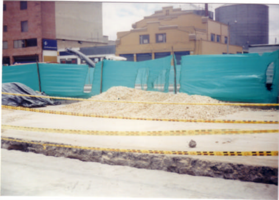
Foto 5. Material de construcción sin cubrimiento.
