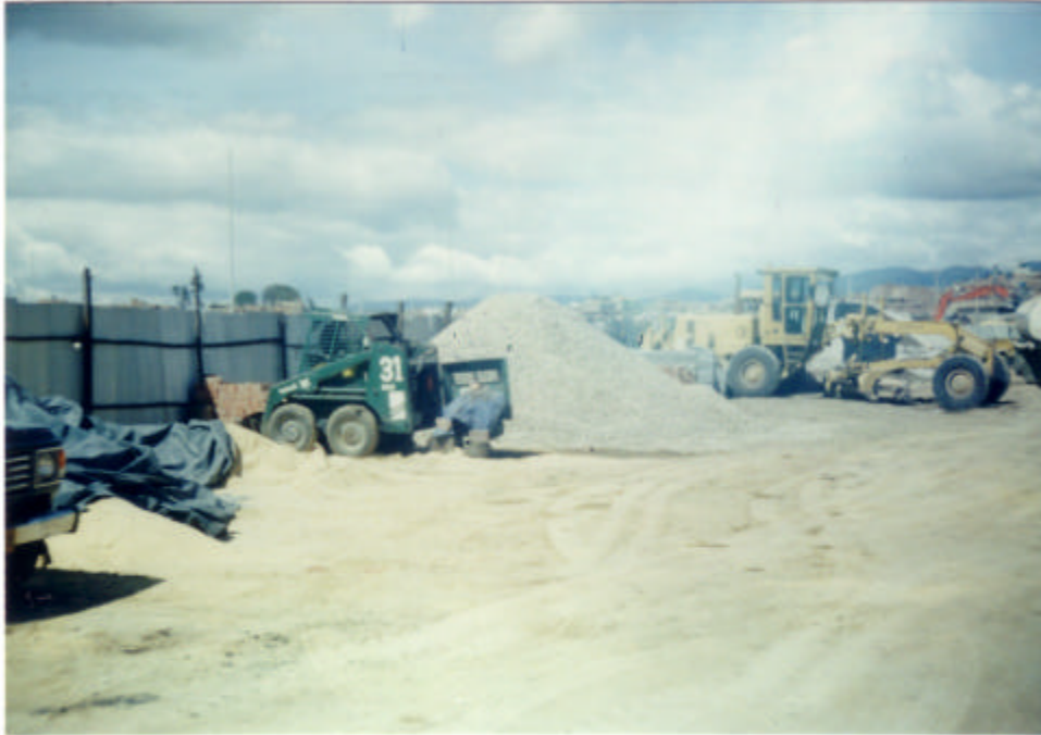
Foto 3. Acopio inadecuado de material de obra.
