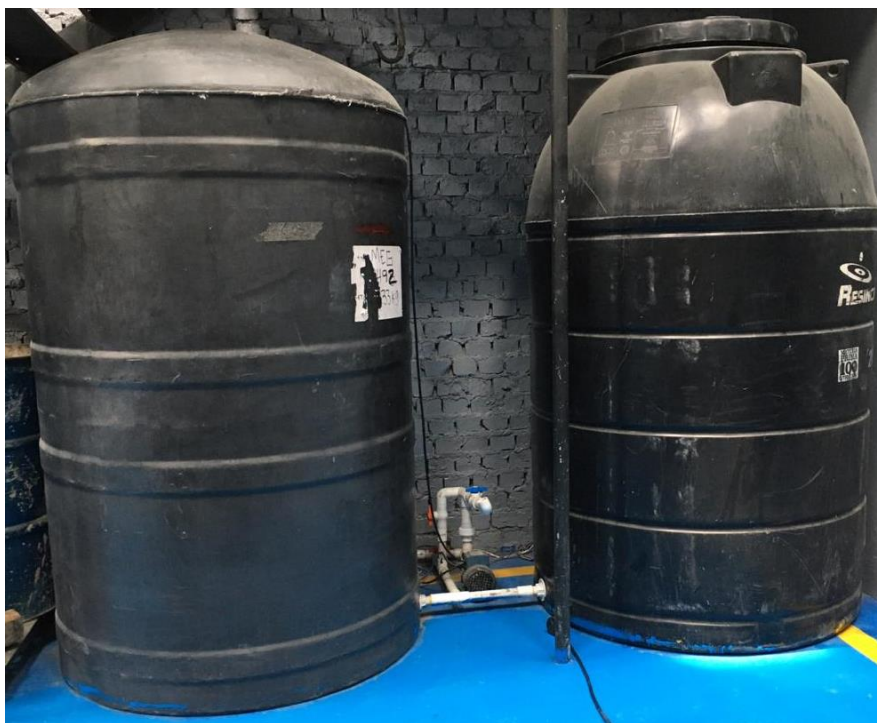
Ilustración 7: Tanques de almacenamiento
