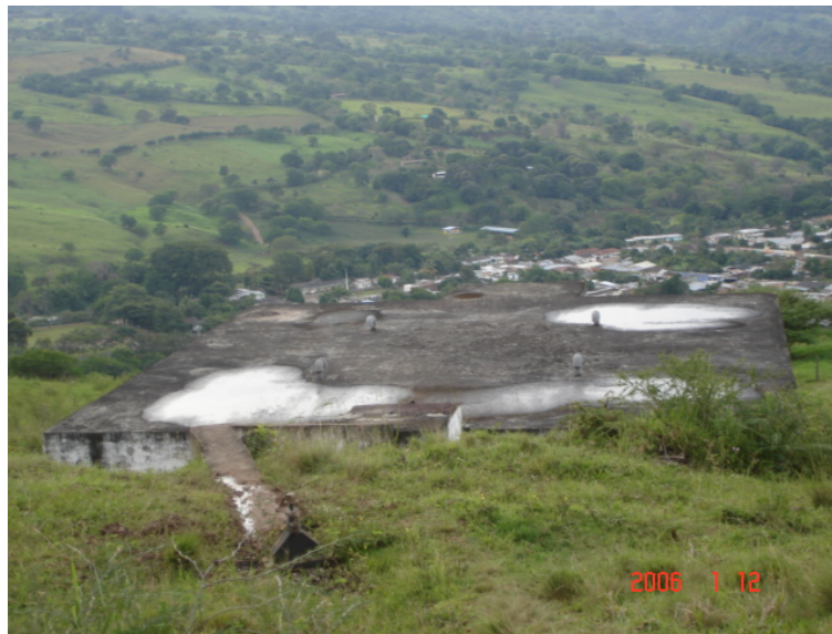
Figura 6. Fotografía tanque de almacenamiento
