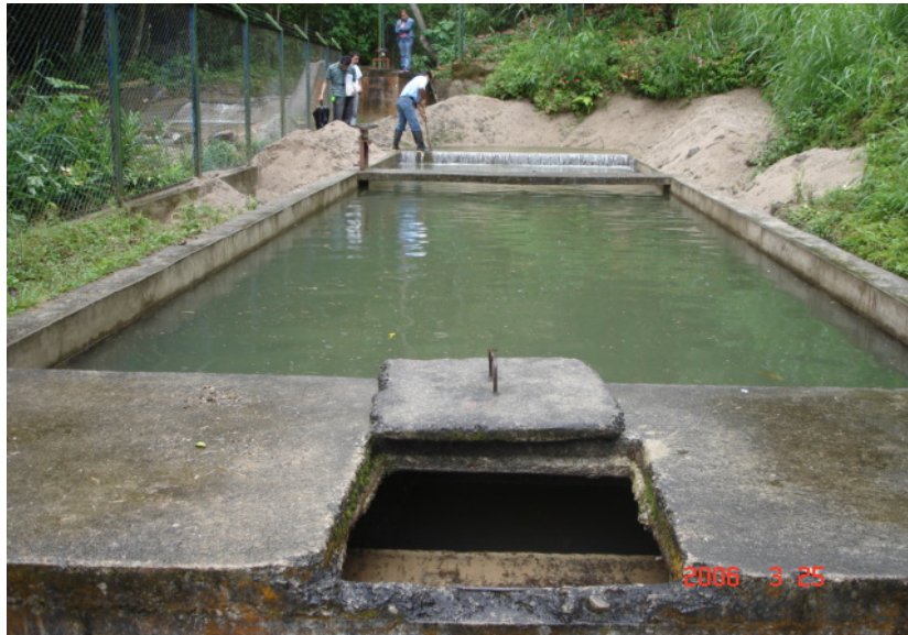
Figura 5. Fotografía desarenador Bocatoma Camenzo
