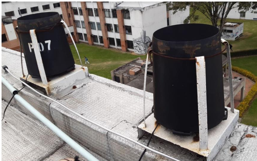
Figura 49 Instalación de pluviómetros Universidad Nacional
