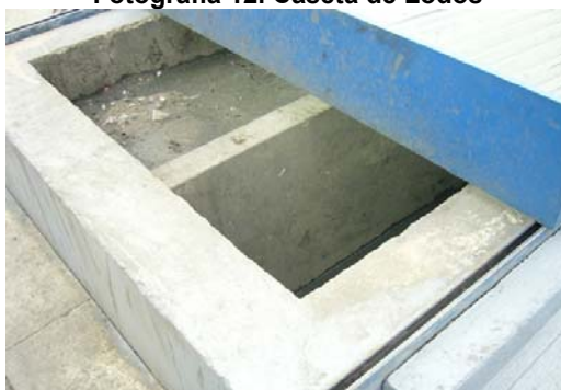
Fotografía 12. Caseta de Lodos
