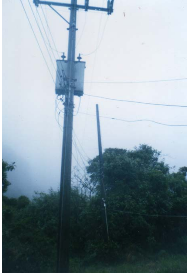
Figura 11. Transformador reductor en el centro San Juan. Vista posterior.
