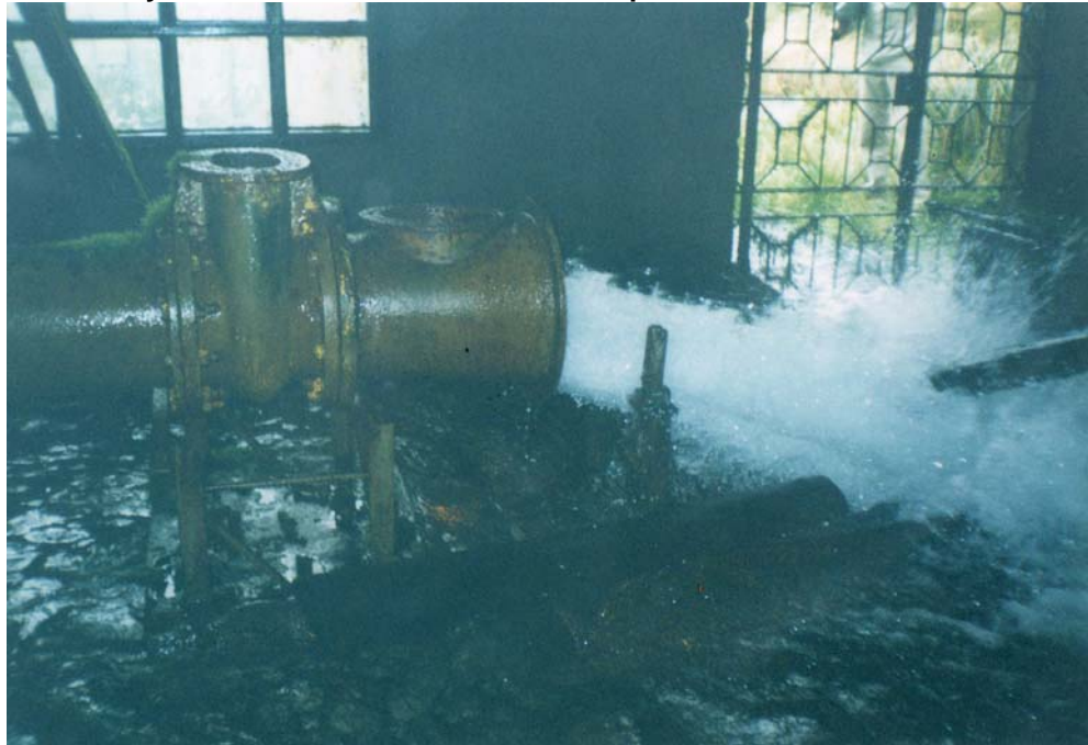
Figura 9. Válvula y final de la tubería en casa de máquinas
