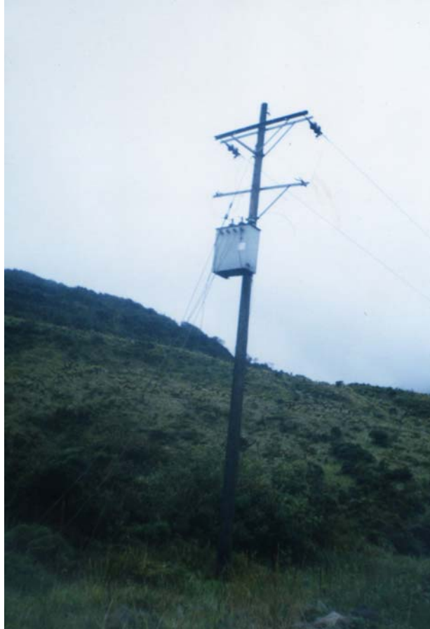
Figura 10 Vista general del transformador elevador
