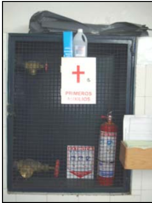
FOTO 37: Gabinete Contra Incendio "Rancho"
