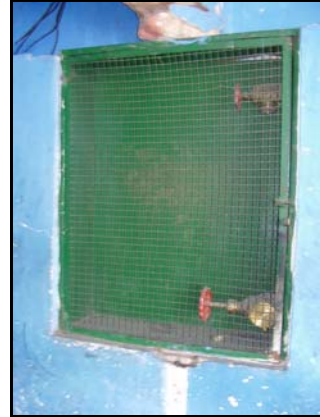
FOTO 86: Gabinete Contra Incendio Pabellón 5
