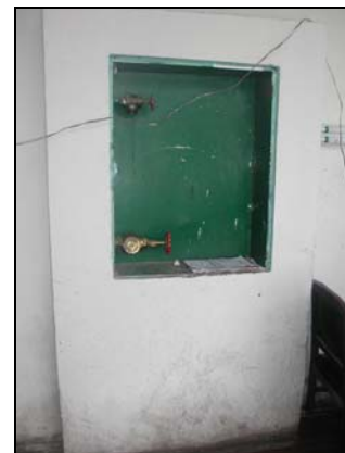
FOTO 36: Gabinete Contra Incendio
