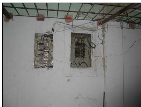
FOTO 30: Cajas y Tacos de Luz
