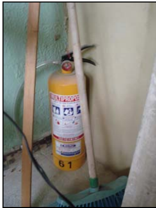
FOTO 17: Ubicación de Extintores ADMON
