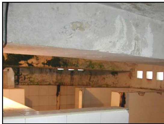
FOTO 59: Eflorescencia y Porosidad
